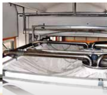
Tubazione di carico e di sfiato
